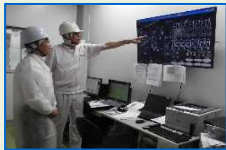
(サイロを一括管理するコントロールパネル)
