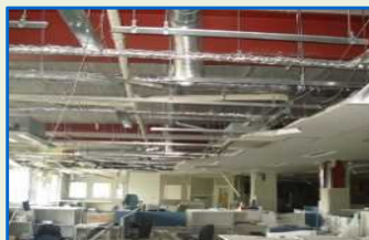
(被災した社屋内部)
